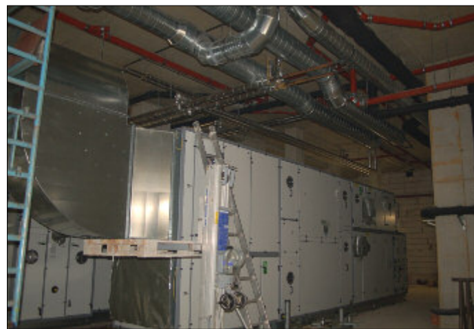
Der künftige Kreistagssaal ist auch auf „dicke Luft“ eingerichtet. Mit moderner Lüftungstechnik, die sich im Stockwerk darunter befindet, kann die Raumluft problemlos gegen Frischluft ausgetauscht werden. Für die gesamte Belüftungsanlage der Kreisverwaltung wurden 7.000 Quadratmeter Feinbleche verbraucht.
