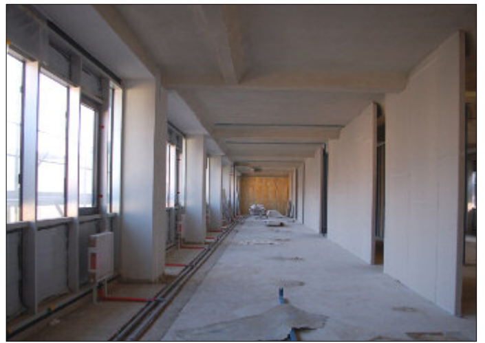
Im Inneren entstehen nach und nach die Büroeinheiten. In modularer Trockenbauweise aufgebaut, können später Wände bei Bedarf problemlos versetzt werden.
