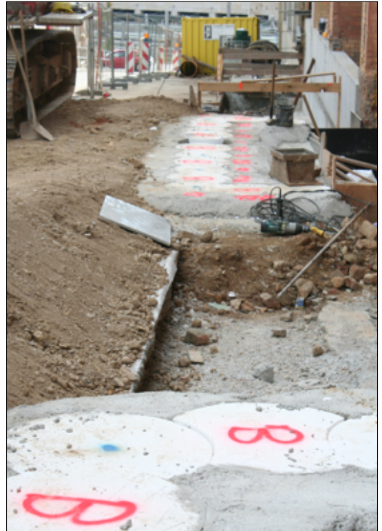
Hier werden 12 Meter tiefe Bohrlöcher gebohrt. Sie haben eine statische Funktion - zur Absicherung der Straße zum Gebäude.
